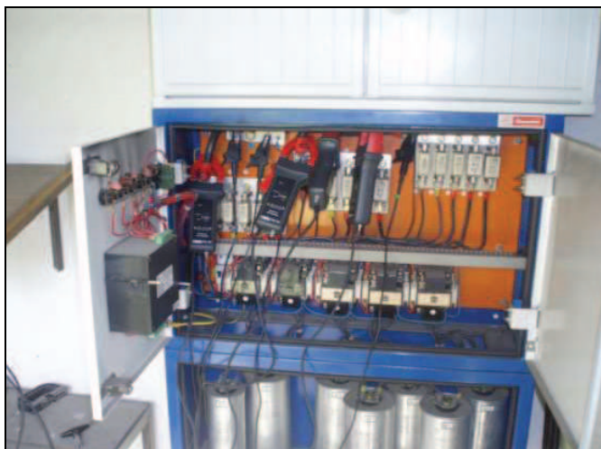
Rys. 6. Widok rozdzielni zakładu z zainstalowaną baterią kondensatorów
